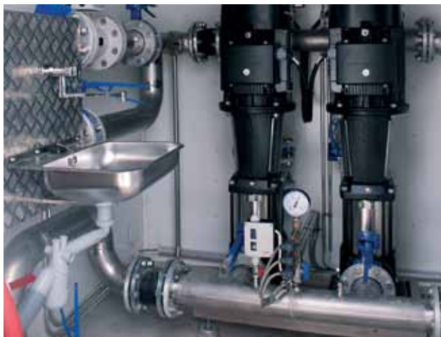
Interiör från pumpstationen vid Nabben.
